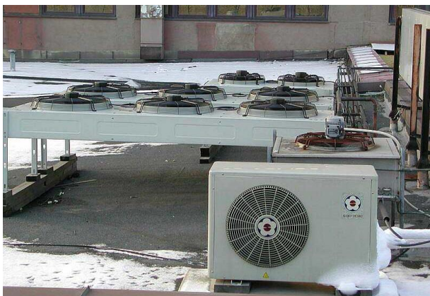
Figur 20. Ulike vifteanlegg er en betydelig støykilde på landsbasis. Foto: Klif
