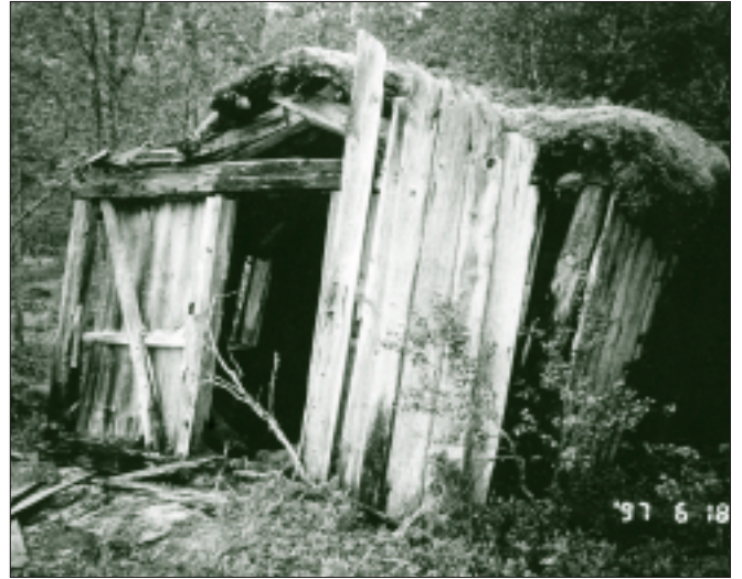
Uthus/stall ved Hjordtalshytta. Dette vil naturen få lov til å ta tilbake - forfallet er kommet for langt. Foto tatt under befaring av utmarksbebyggelsen i 1997.
