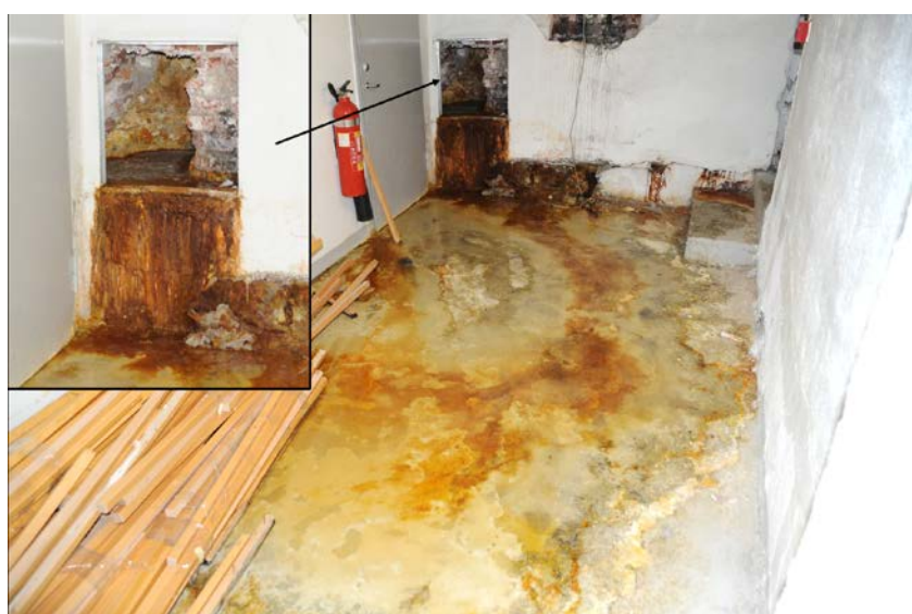
Figur 3 Innlekkasje av aggressivt vann (pH < 3) i et kjellerrom. Kontakt med vannet kan medføre fare for etseskader på huden. For vannkjemi, se Vedlegg C, Tabell C3, Prøve 1.
