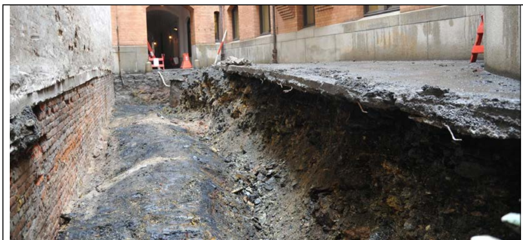
Figur B2 Her var alunskifer brukt til å tilbakefylle under dekke i en bakgård. På grunn av at det er høydeforskjeller mellom naboeiendommer, oppsto et vannsig gjennom disse massene. Her var også dreneringen defekt og hadde åpen kum (ingen bunn). Det medførte at overflatevann fra takarealer ble ført ned i grunnen via kummene som var åpne i bunnen. Løsningen her ble å injisere skifervolumet slik at vannsaget ble stanset og samtidig oppgradere dreneringssystemet for eiendommen.
