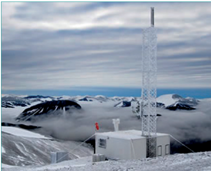
Det er satt opp flere større installasjoner for telekommunikasjon på Svalbard de siste årene. Dette bildet viser et fjelltoppanlegg med antenner og tilhørende strømforsyning på Gunnarberget, like sør for Van Mijenfjorden. Foto: Getek AS
